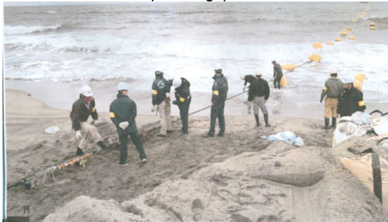
Figura 2 - Instalação de cabo de fibra óptica, no Japão, em 2012, para a conexão Japão-Cingapura.
